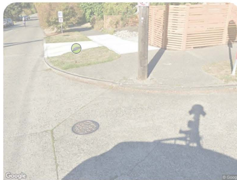
Curb Ramp Severity ○ ○ ○ ○ ○ ○ Tags missing tactile warning
